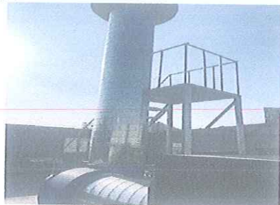
废气治理设施图 1
