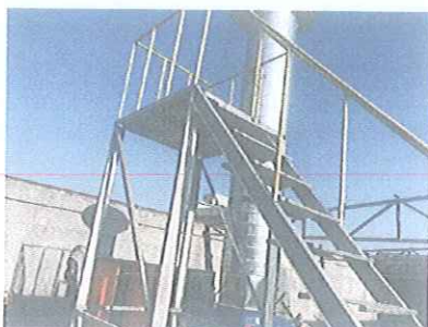
废气治理设施图 2
